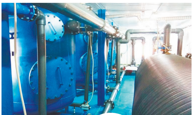
Перекачивающая станция Восточной системы водоснабжения.
