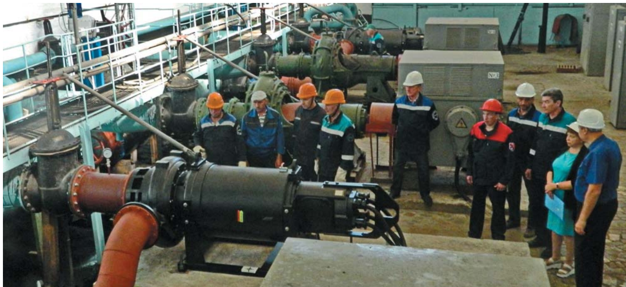
Рис. 6. Работающий новый насос
